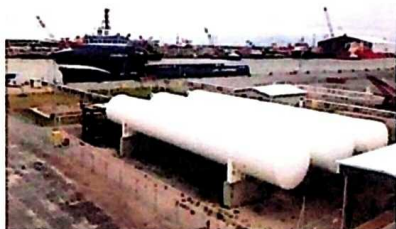
LNG Facility Port Fourchon
